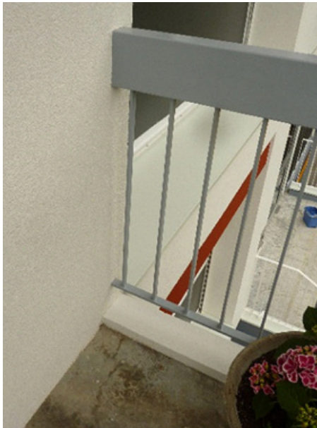
La profondeur des balcons, un élément déterminant dans le choix de l'épaisseur de l'isolant, ASDER, 2015
