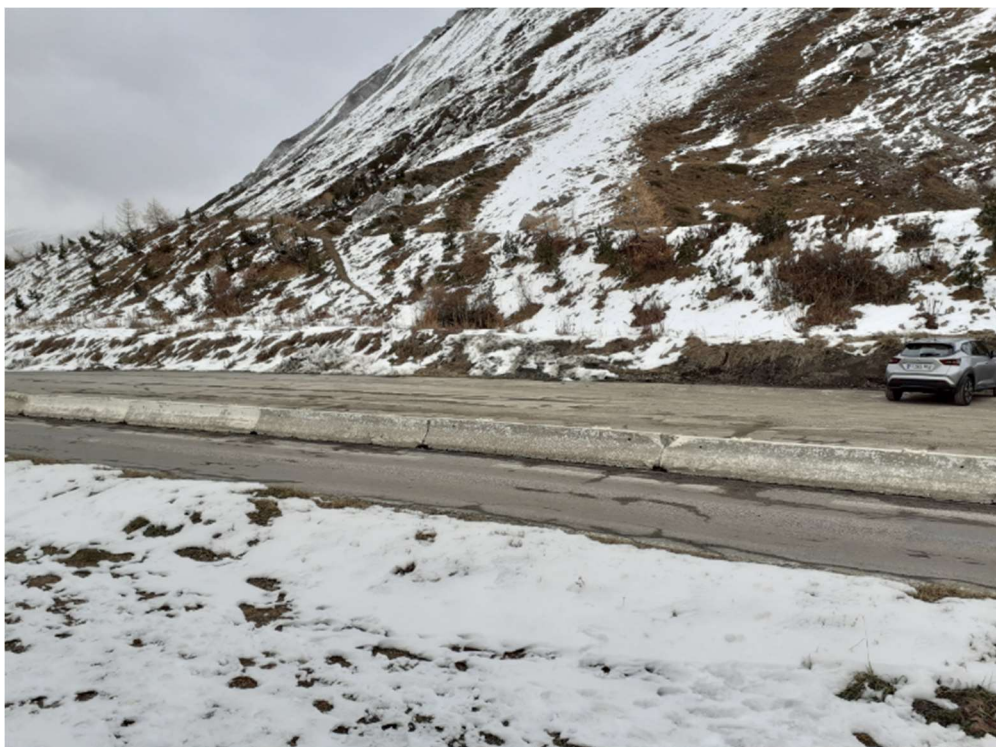
Photographie 10 : Site et merlon paravalanche en bordure est depuis la route du Golf
