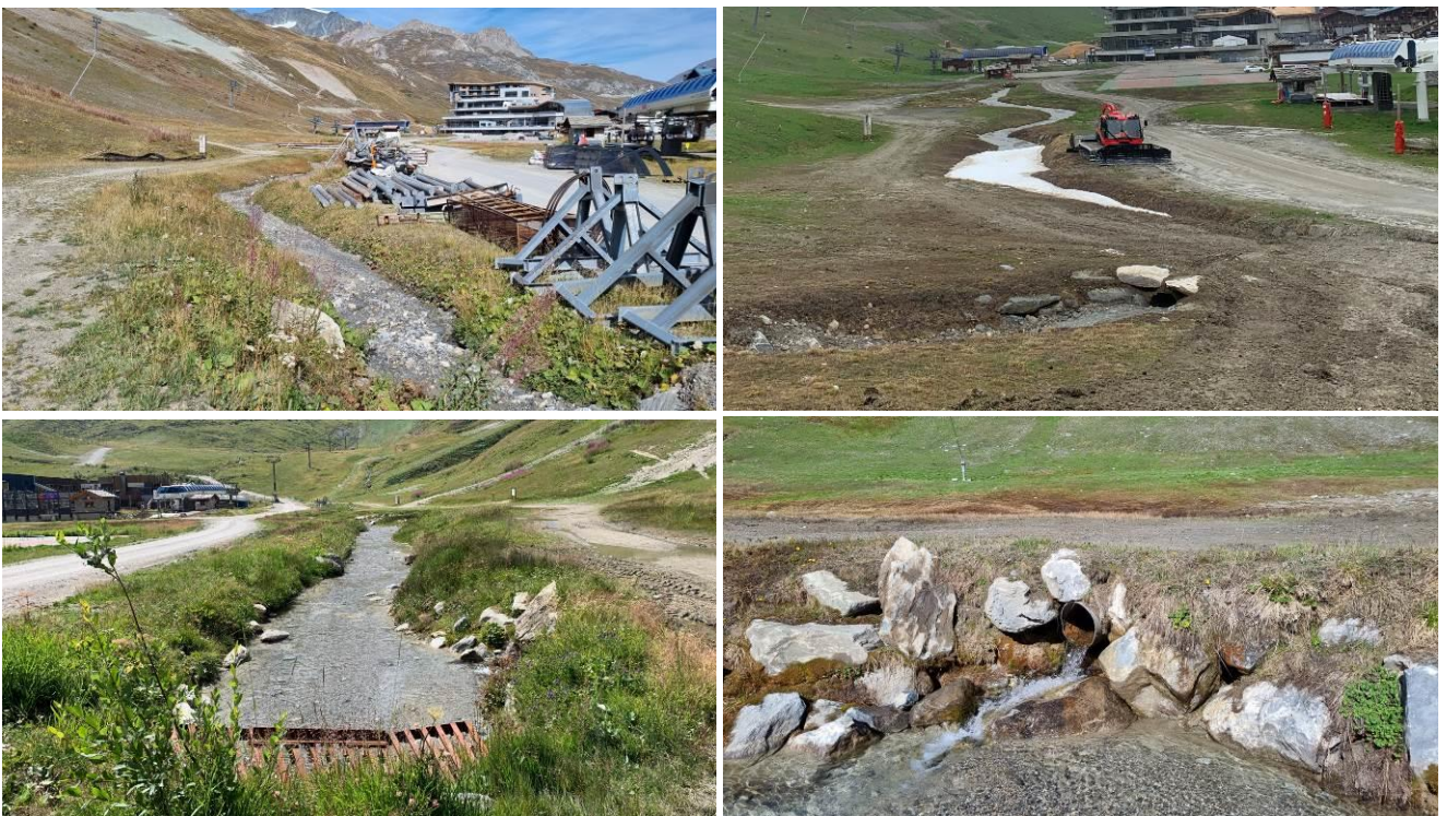
Figure 11 Vues des différents facteurs d'altération des milieux existants (entreposage de matériels et circulation d'engins en berge, drainage et captage des sources sous la piste rive gauche) et de l'extrémité aval du tronçon, constituée par un regard béton muni d'une grille (photos biotec 01.06.2022, 08.06.2022, 04.07.2022, 23.09.2022)
