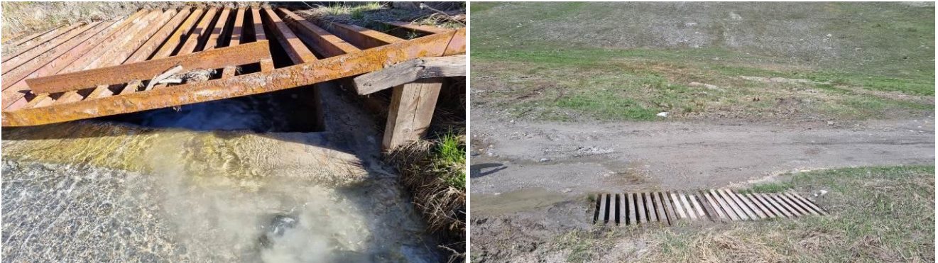
Figure 14 Vues de l'entrée du réseau enterré (regard béton) et d'un des regards de visite intermédiaires équipés de grilles avaloir (photos biotec 01.06.2022)
