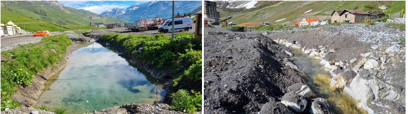
Figure 19 Vues du linéaire de cours d'eau à ciel ouvert sur le tronçon 2 fortement impacté par de récents travaux d'aménagement (photos biotec 01.06.2022)
