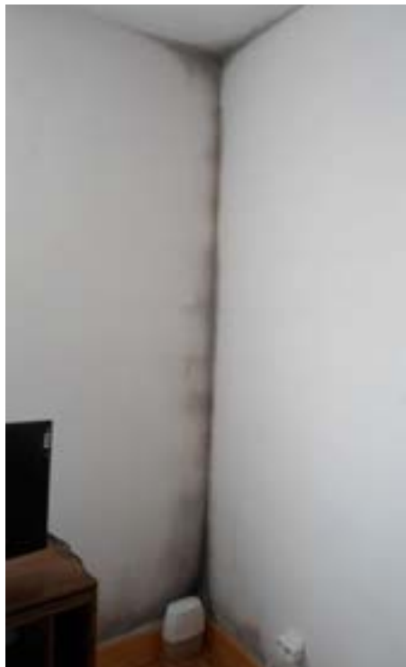
Moisissures et mauvaise ventilation, ASDER, 2015
