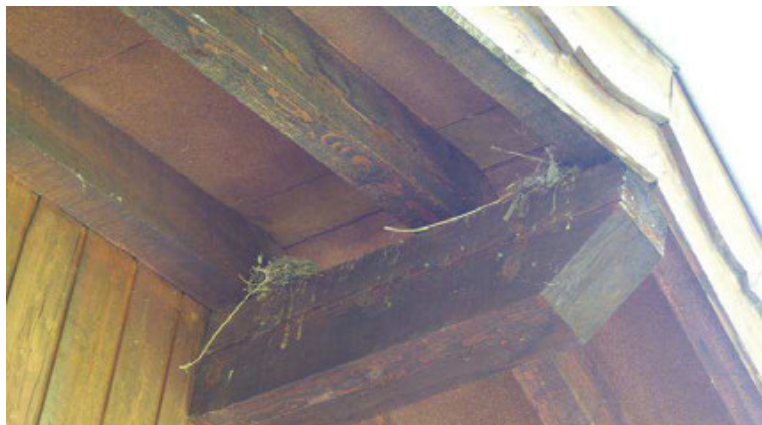
Figure 124 : Nids de Rougequeue dans le bâtiment du Vestiaire du terrain de sport (Photo EPODE)
